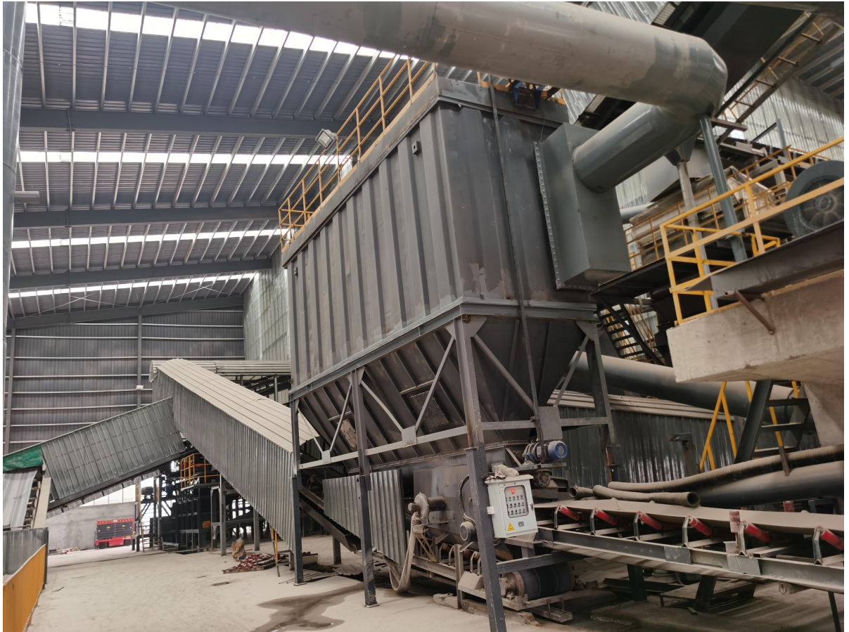
图 3-10 布袋除尘器（二破、振动筛分 1、1#料仓、2#料仓废气处理设施）照片
