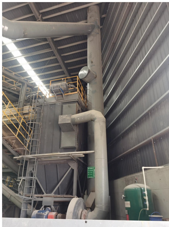
图 3-10 布袋除尘器（3#料仓、4#料仓/5#料仓废气处理设施）照片
