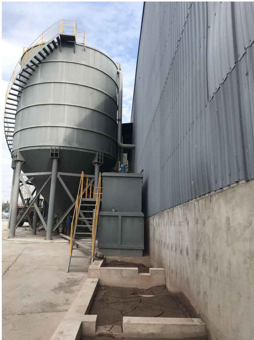
图 3-4 水洗、洗砂废水处理设施照片
