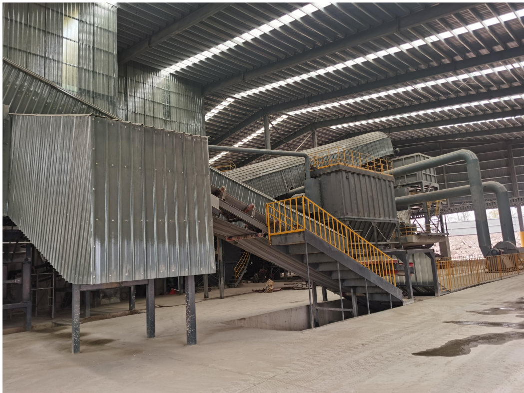
图 3-7 车间内输送带密闭照片 2
