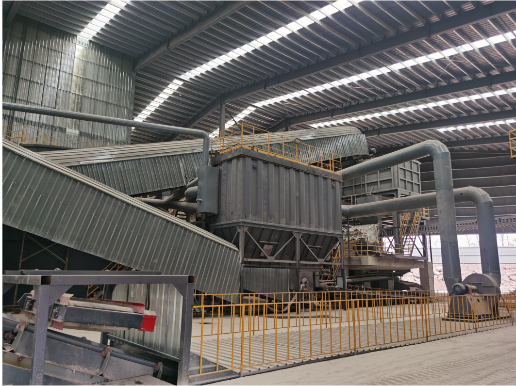
图 3-6 车间内输送带密闭照片 1
