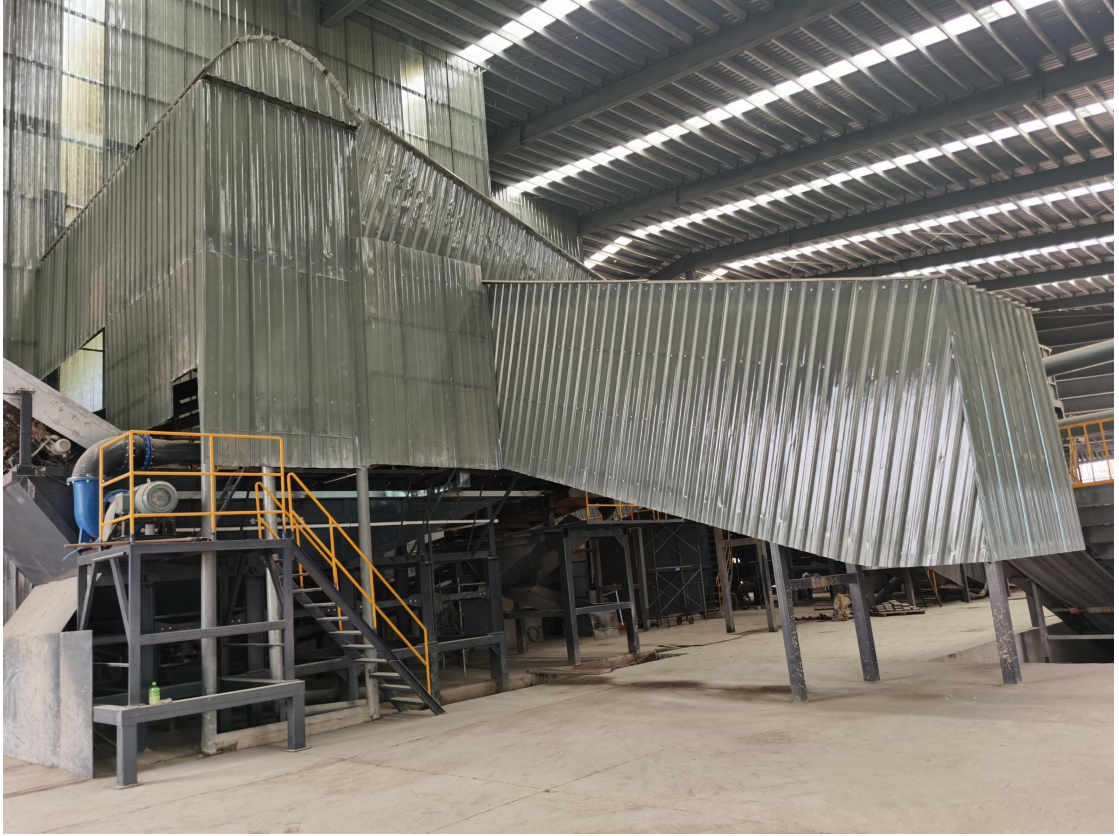
图 3-8 车间内输送带密闭照片 3
